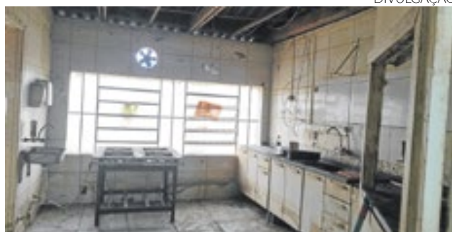
Todos os ambientes foram destruídos pelas águas
