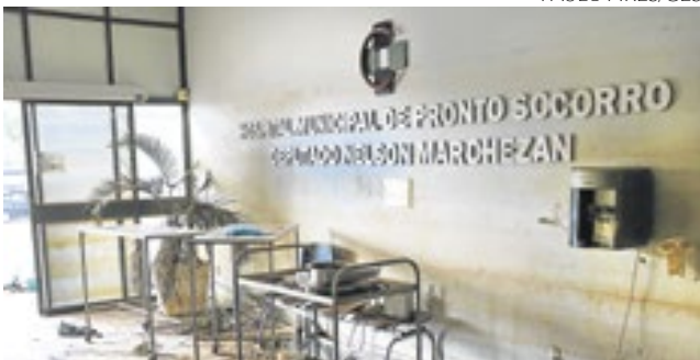
Estrutura interna do hospital no primeiro piso foi destruída
