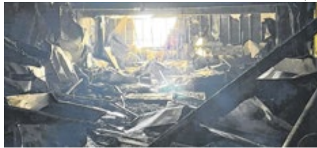
Sinistro comprometeu 85% da estrutura do atrativo
