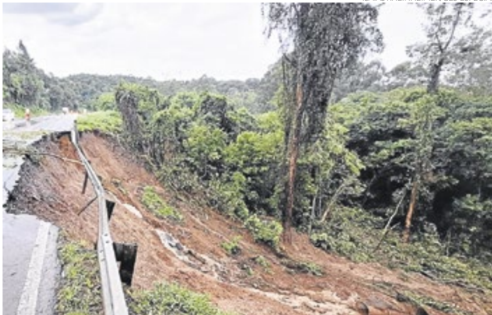
Deslizamento no quilômetro 232 da BR-116 em Estância Velha no limite com Ivoti
