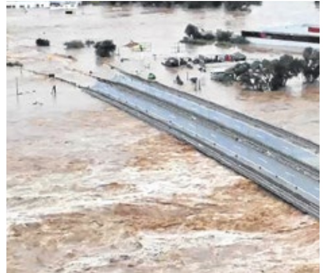
Ponte sobre o Rio Taquari, na BR-386, entre Lajeado e Estrela, está interditada desde às 19 horas de quarta-feira
