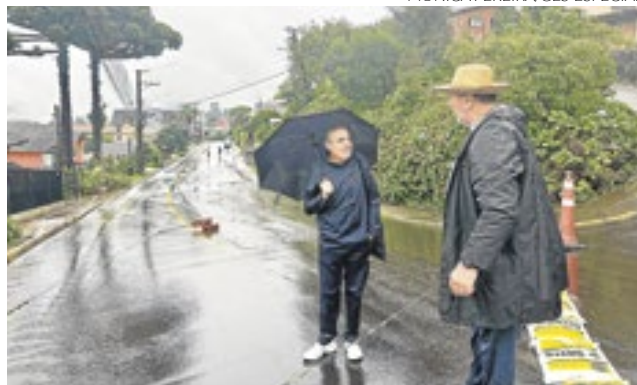
Fissura no asfalto apareceu Rua Henrique Bertoluci
