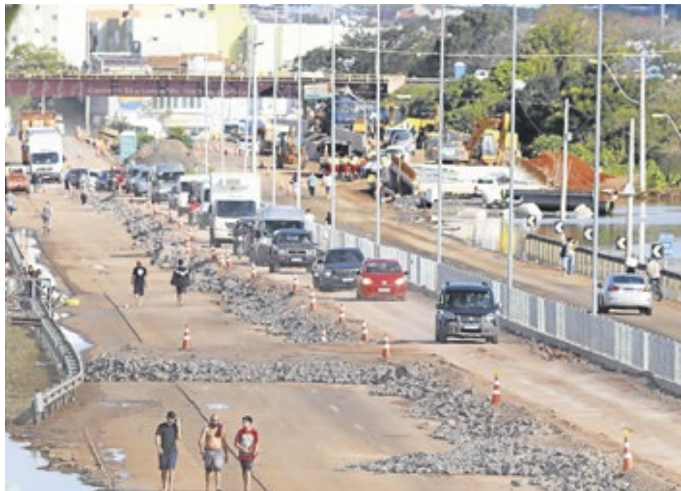
Tráfego na BR-116 voltou emergencialmente após seis dias de interdição total das pistas nas pontes de São Leopoldo. Tráfego é em uma faixa, com fluxo alternado no sistema pare e siga
