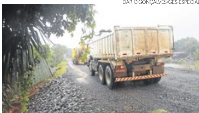
Caminhões trafegavam sobre a crista do dique no domingo
