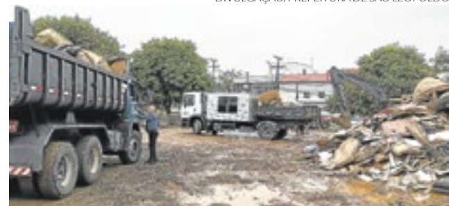
Entulhos são recolhidos de locais onde a água já baixou
