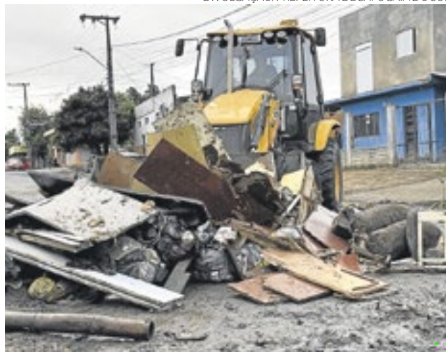
Limpeza dos entulhos onde a água da enchente já baixou
