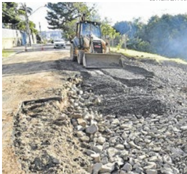
Trecho da Rua Cuiabá desmoronou com as chuvas
