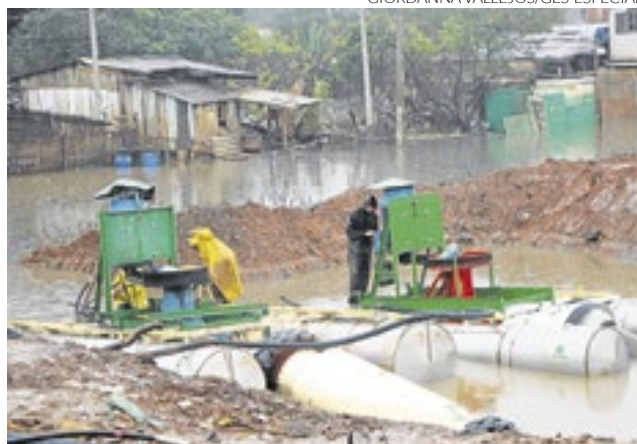
Vila Palmeira anseia por agilidade na drenagem da água
