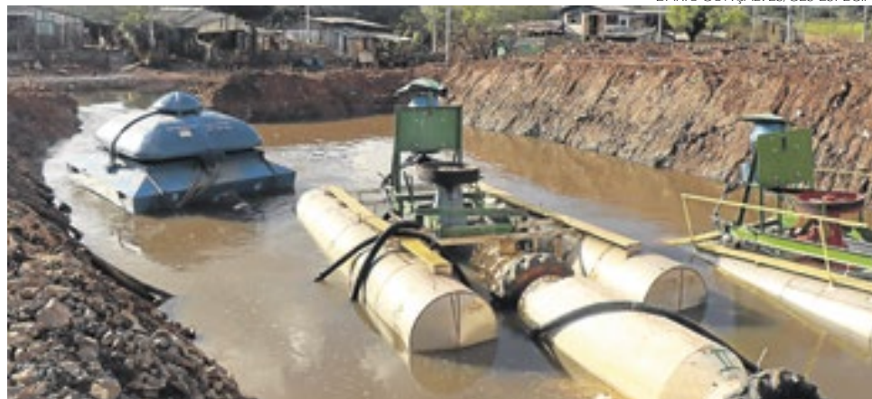
Bombas dos arrozeiros junto ao equipamento da Sabesp no dique da Santo Afonso
