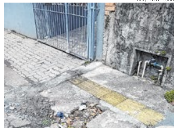
Moradores apontam rachaduras e afundamentos na via
