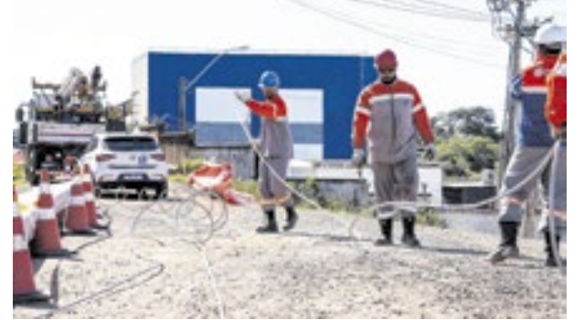
Rede de média tensão em expansão na Casa de Bombas
