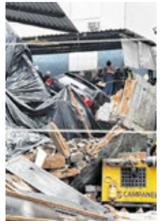
Deslizamento provocou danos materiais
