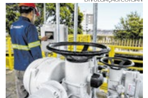
Sistema de vazão da Corsan
