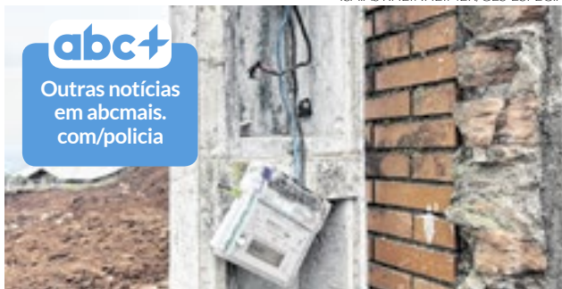
Equipamentos danificados indicam os crimes na área
