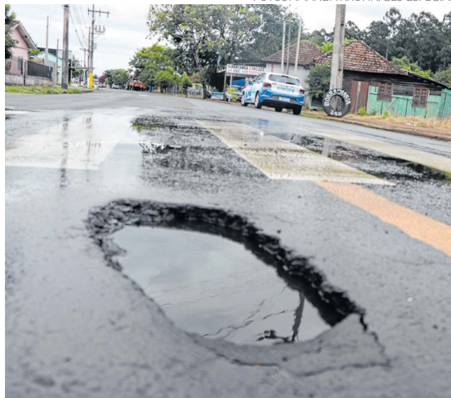
Vazamento de água causou erosão e Corsan vai consertar
