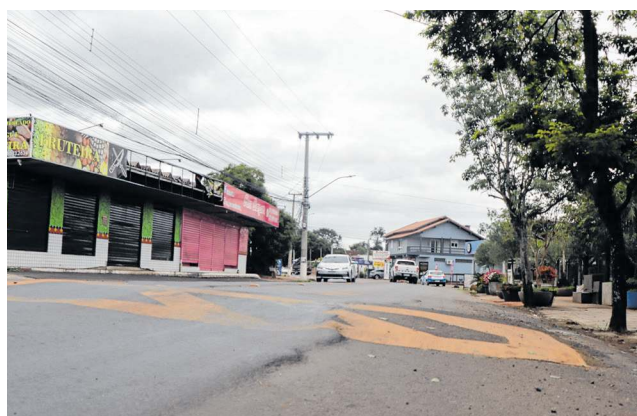
Asfalto desgastado e com desnível em quebra-mola
