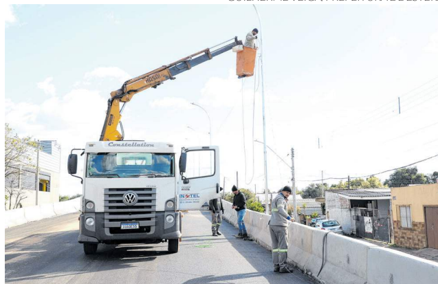
Viaduto da Avenida Celina Kroeff recebe iluminação
